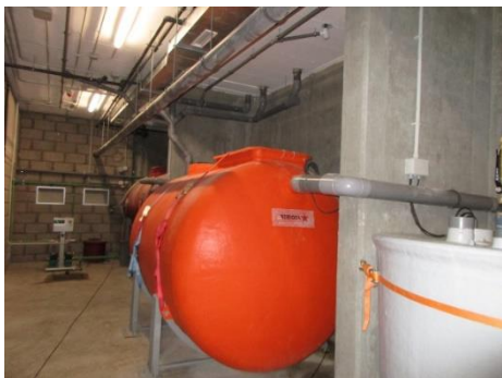
Ilustración 10. Planta de ósmosis inversa
