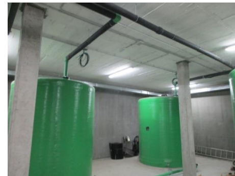
Ilustración 12. Depósitos de agua marina
