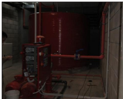
Ilustración 11. Depósito contra incendios
