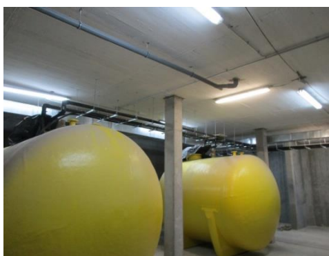
Ilustración 14. Depósitos de gasoil
